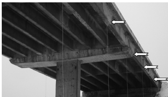
Rys. 3. Czujniki zamocowane na dźwigarze wiaduktu
