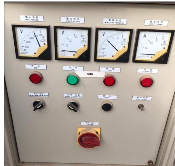
Fig. 2. The Transformer Rectifier.
